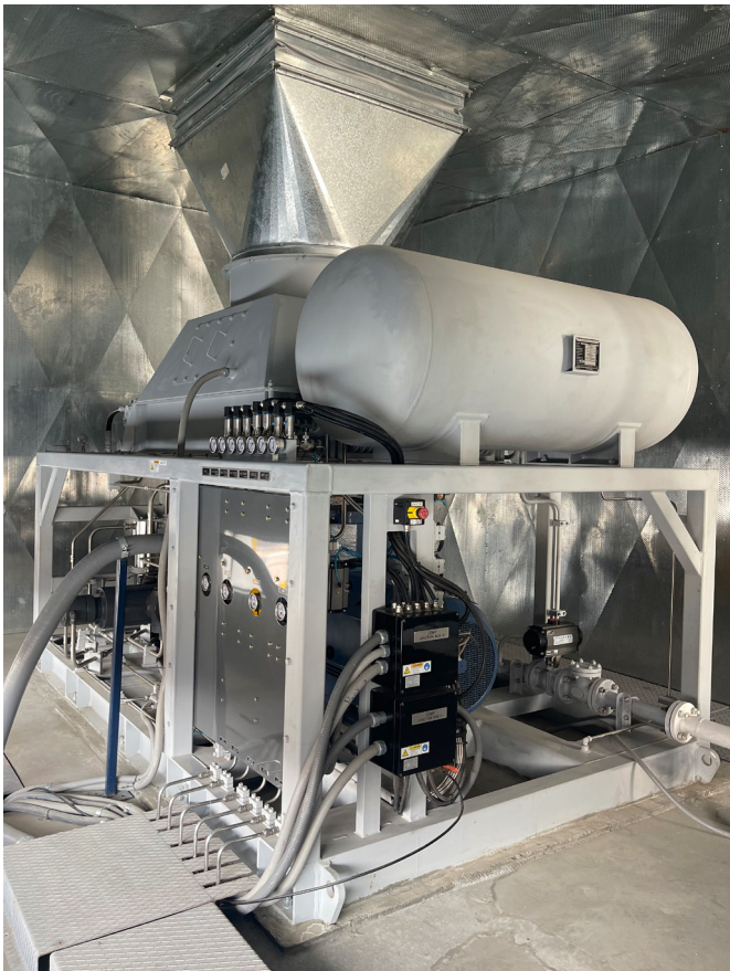
CARGAS 충전소 설치 GEO-BII CNG 압축기
